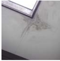
軒の雨漏れ状態
