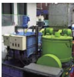
グラウト注入設備
