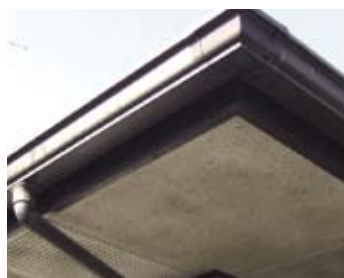
軒天劣化状況
