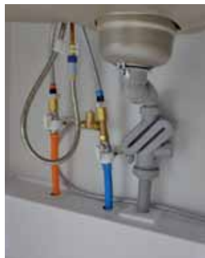
室内排水管点検
